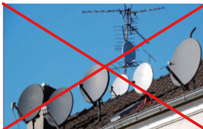
Abb. 117- negativ: überladene Dachfläche
