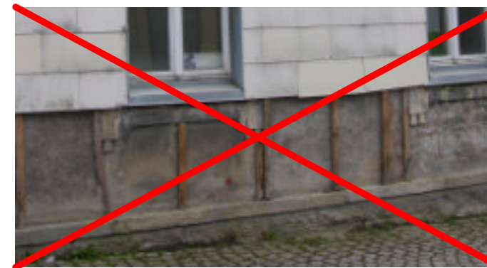
Abb. 44 - Negativ: Nachträgliche Fassadenverkleidungen sollten zurückgebaut werden, um die ggf. vorhandene historische Fassadengestaltung wieder sichtbar zu machen.
