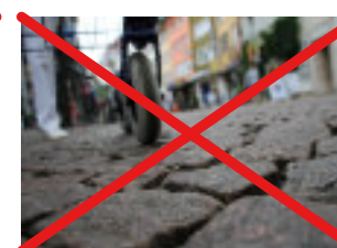
Abb. 205 - Negativ: unebener Pflasterbelag
