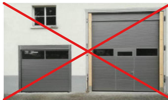
Abb. 65 - Negativ: unpassende Garagentore aus Kunststoff im historischen Nebengebäude
