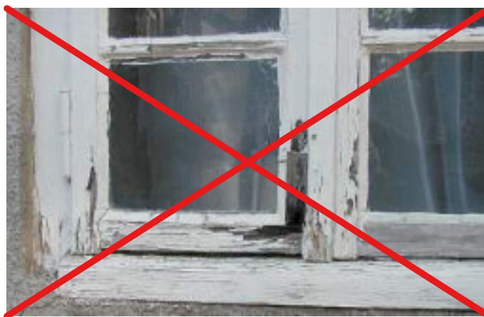
Abb. 149 - Negativ: undichtes Fenster
