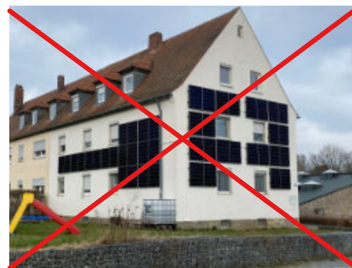
Abb. 135 - Negativ: Solarmodule stören den optischen Eindruck der Fassade
