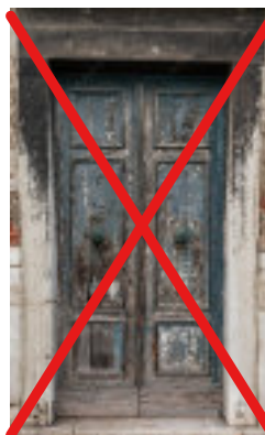
Abb. 150 - Negativ: undichte Eingangstür
