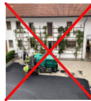
Abb. 186 - Negativ: Asphaltierter Hofbereich, Hofflächen und -zufahrten sind nur im unbedingt erforderlichen Umfang zu befestigen. Eine Asphaltierung der Hoffläche ist aus ökologischen und ortsgestalterischen Gesichtspunkten (monotones Erscheinungsbild, hoher Versiegelungsgrad) zu vermeiden.
