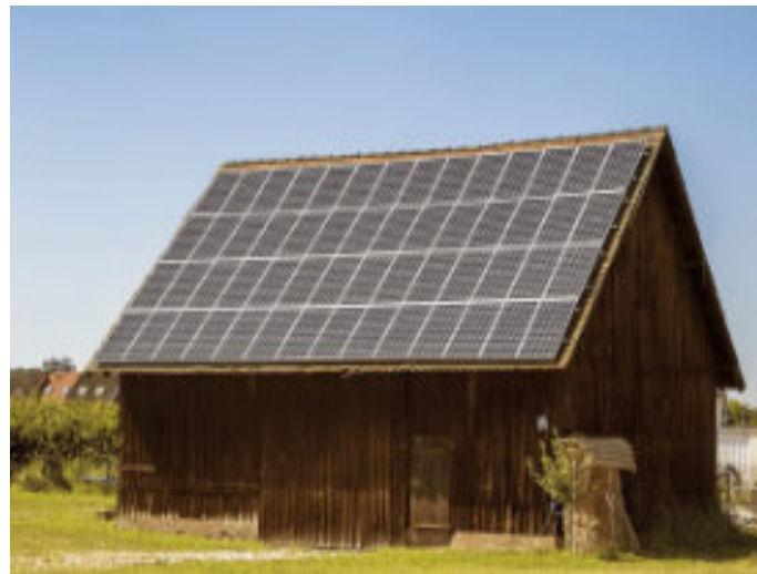
Abb. 131 - Solaranlage auf einem Nebengebäude
