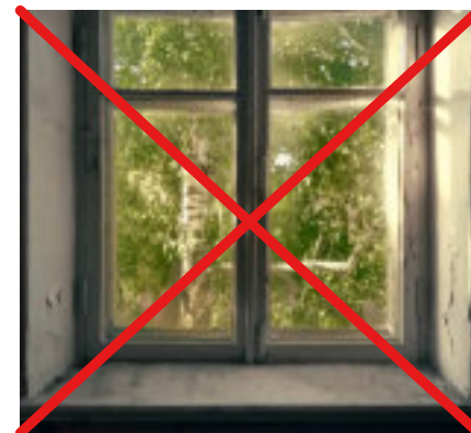
Abb. 151 - Negativ: Kondensat fördert Schimmelbildung
